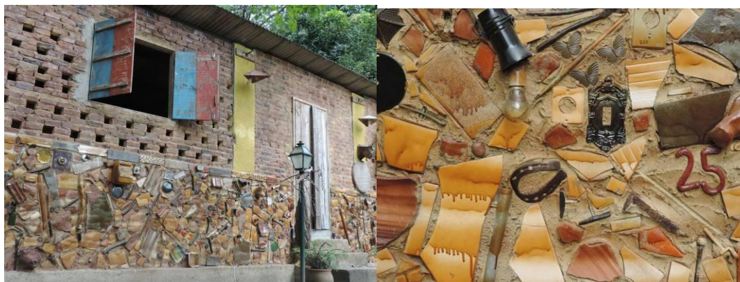
Figura 5: À direita vista da parede feita com materiais reutilizados e à esquerda detalhes da parede.
